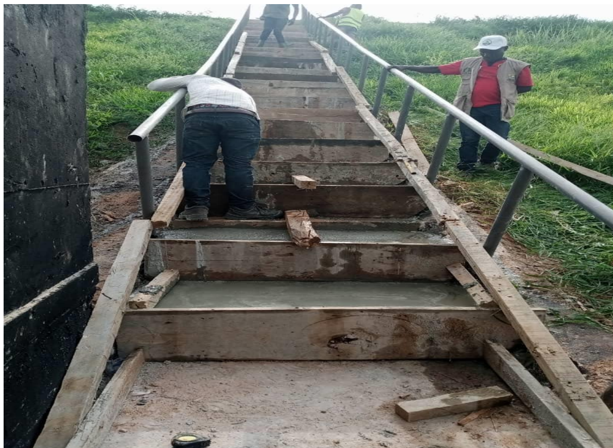
Coffrage et coulage d'escalier donnant accès à la chambre de vanne dans projet de construction du barrage de Raviart et d' aménagement de 125 hectares de périmètre
