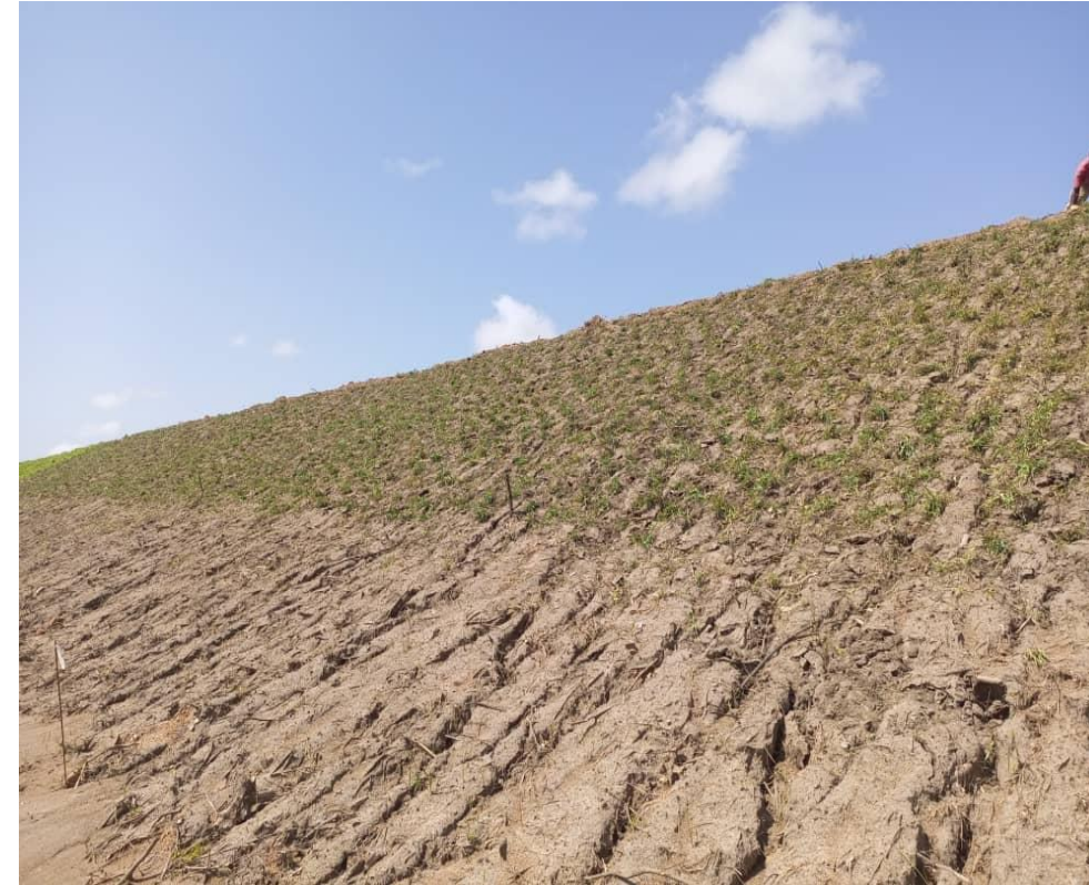
Engazonement de la digue dans le projet de construction du barrage de Raviart et d'aménagement de 125 hectares de périmètre
